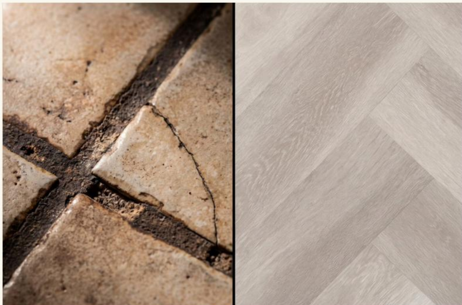
Joints de ciment fissurés et tachés (carrelage) vs surface continue sans joint (SPC à Coller)
